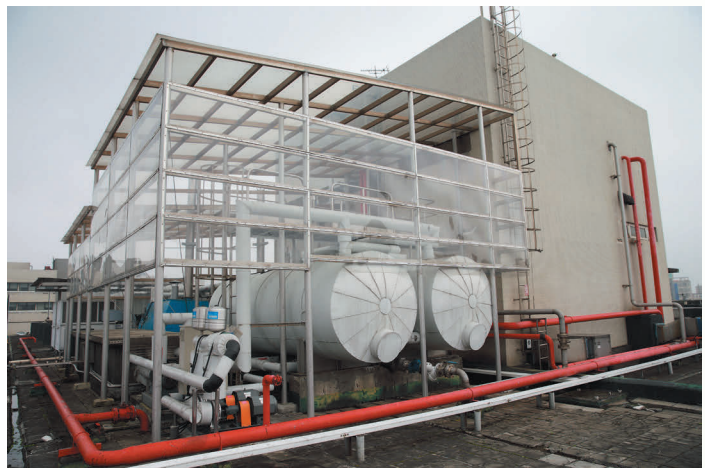
2012 年建置熱泵系統，達到節油功效
